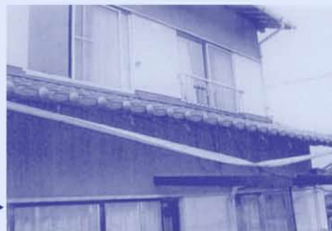
雪の重みで雨樋が破損したSさん宅
